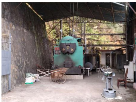
技改后的生物质锅炉
